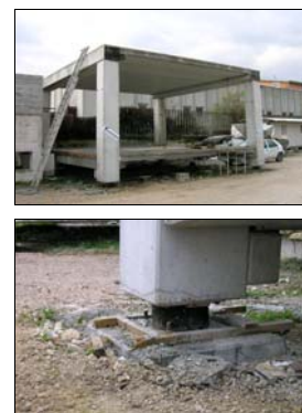
Struttura a Base Isolata (BF)
