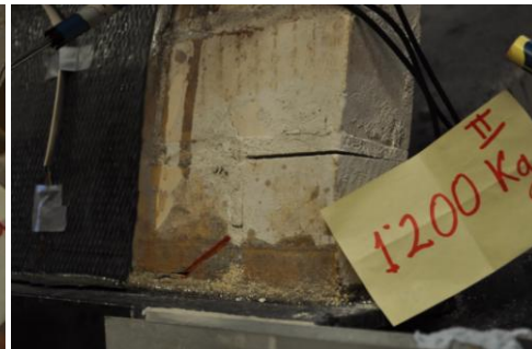
Figura 10-Fessure trasversali in prossimità della spalla fissa.
