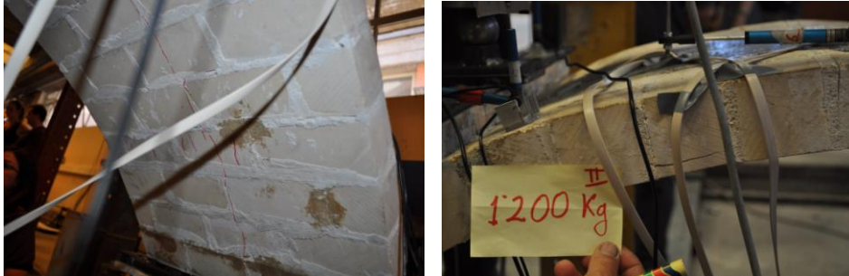
Figura 8-Fessure per schiacciamento dei mattoni all'intradosso
